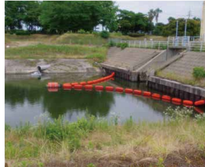
岡山県 片島排水機場 簡易網場
