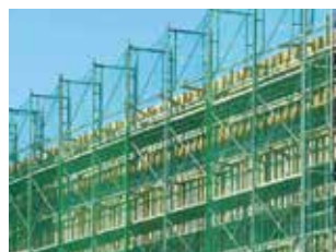
建築養生ネット
